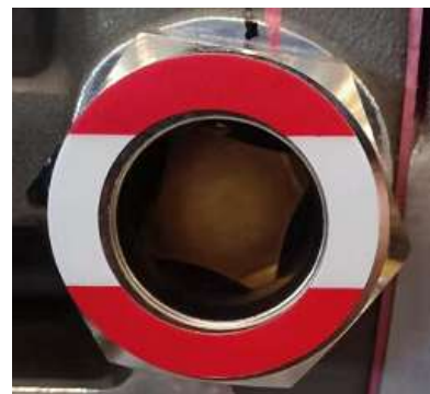
Figura 2.3 Diagrama esquemático del nivel de aceite por encima del límite superior del espejo de aceite
